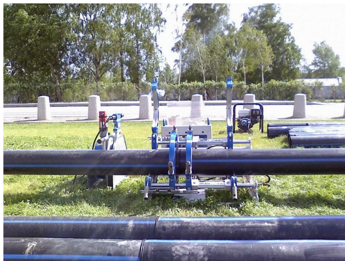
Рис. 3 - Надземная система прокладки трубопровода.
