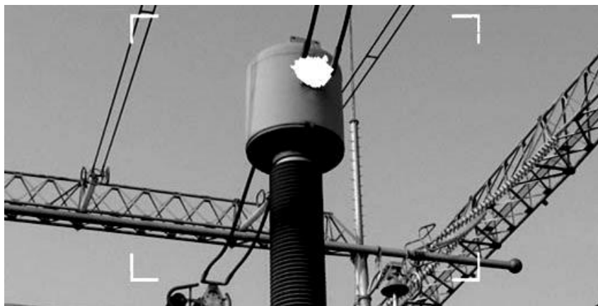
Рисунок 2 – Наложение УФ-изображения разряда на видимое изображение, демонстрирующее результат обнаружения дефекта на ЛЭП
